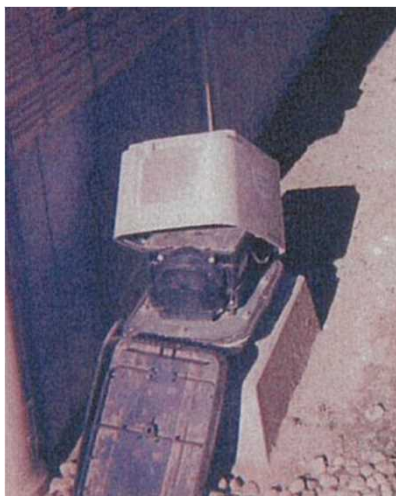
故障した浄化槽ブロー（改築前）
